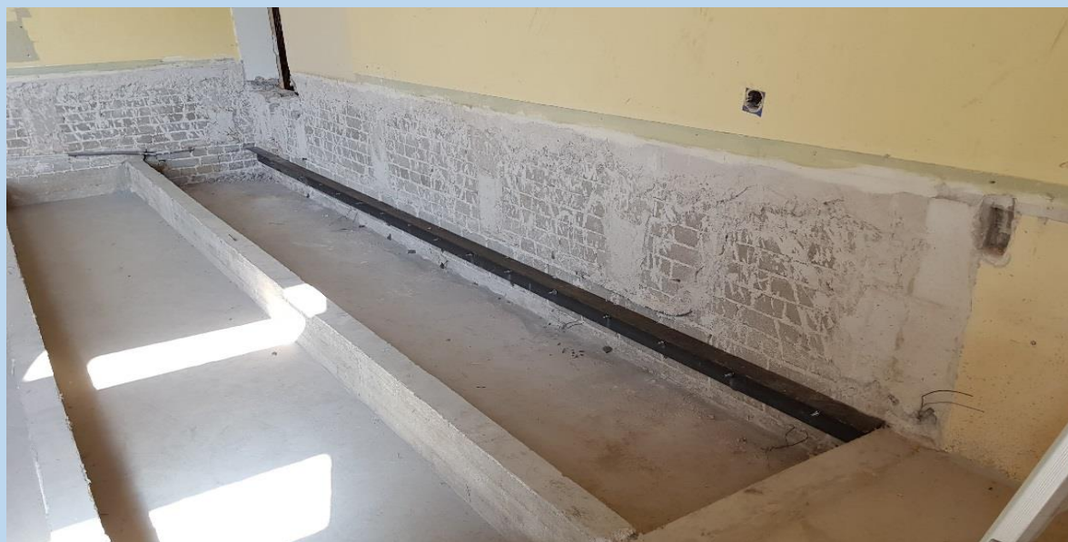
Kuva 3. Liikuntasalin lattiapalkiston tuenta
